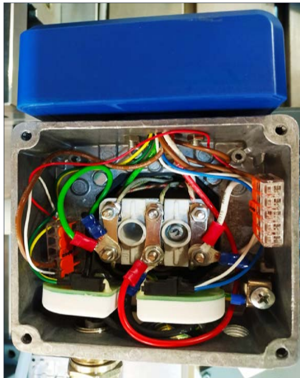
Abb. 22: Montiertes Messmodul am Motorklemmkasten
